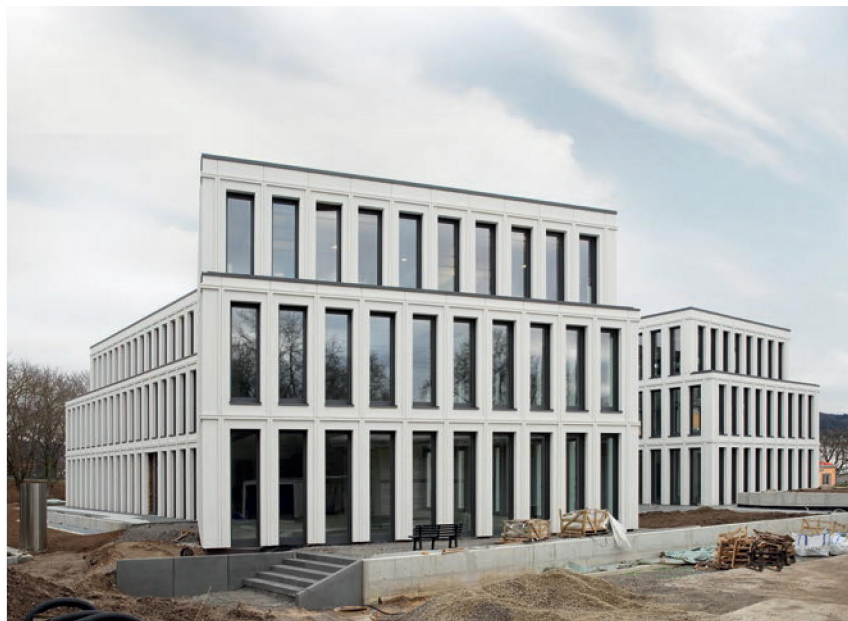
Das Gebäude trägt im Volksmund bereits den Namen „Akropolis von Weinheim“. Doch anders als bei dem griechischen Namensgeber beruht die Ästhetik dieses Gebäudes nicht auf Säulen, sondern auf Betonsandwichelementen.
